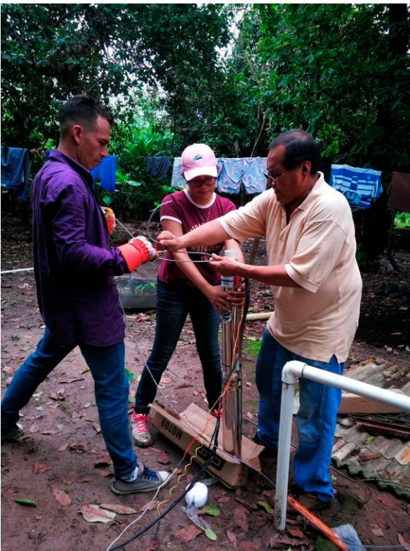
Figura 6. Mantenimiento a bombas. ECOENERGIA. Fuente: Br. Wilfredo Ramírez y Br. Rosa Melania Araúz.
