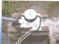
Vista parcial al Hidrogenerador
