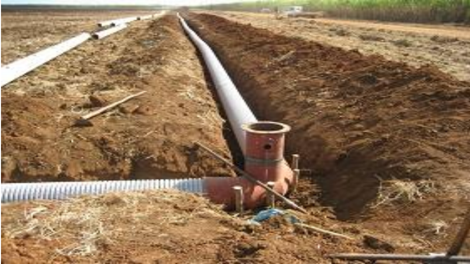
Figura. 1 Tubería de conducción soterrada e hidrante.
